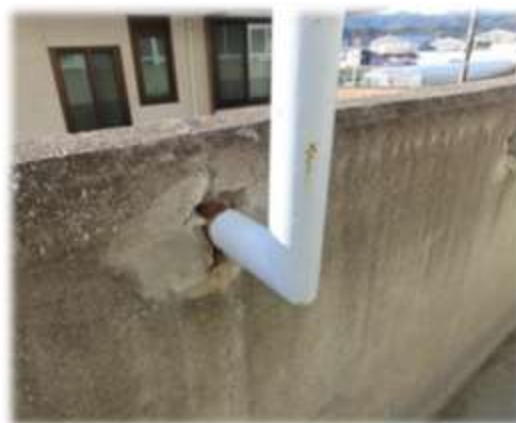
ベランダ手摺り部分爆裂（伊野中）※改修済
