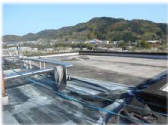
防水シートの剥離した屋上（伊野南小）※改修済
