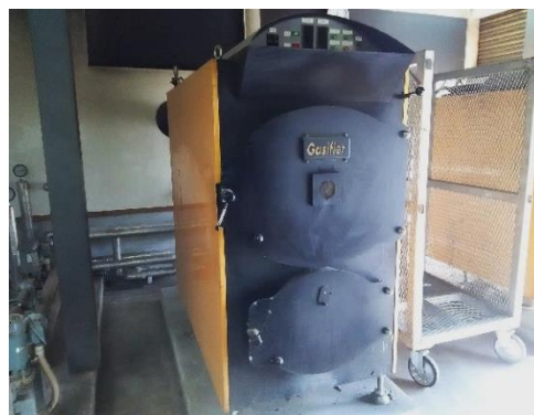
木質バイオマスボイラー
