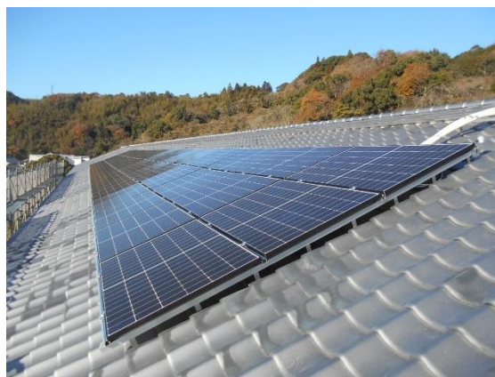
伊野南中学校太陽光発電設備導入工事
