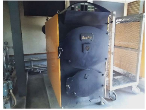
木質バイオマスボイラー
