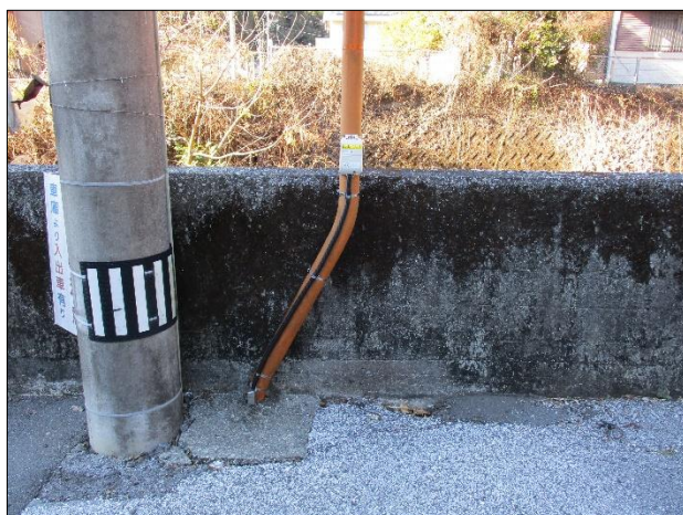
設置箇所②(遠景)
