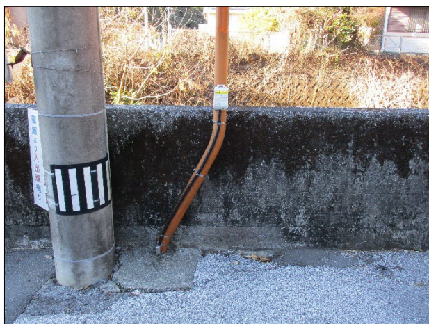
設置箇所②(遠景)
