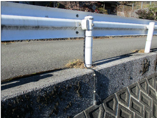
設置箇所①-1 (遠景)
