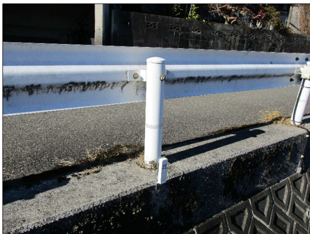
設置箇所①-2 (遠景)
