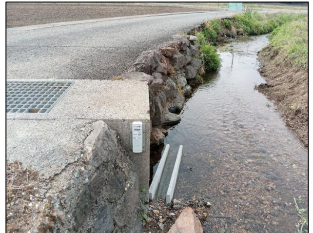
設置箇所（近景）
