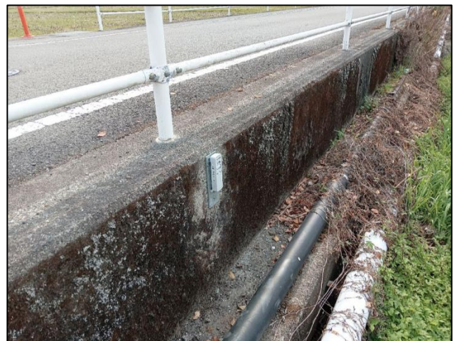
設置箇所（近景）
