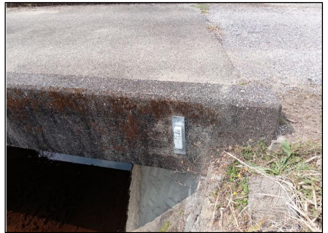
設置箇所（近景）
