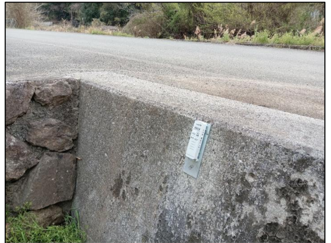
設置箇所（近景）
