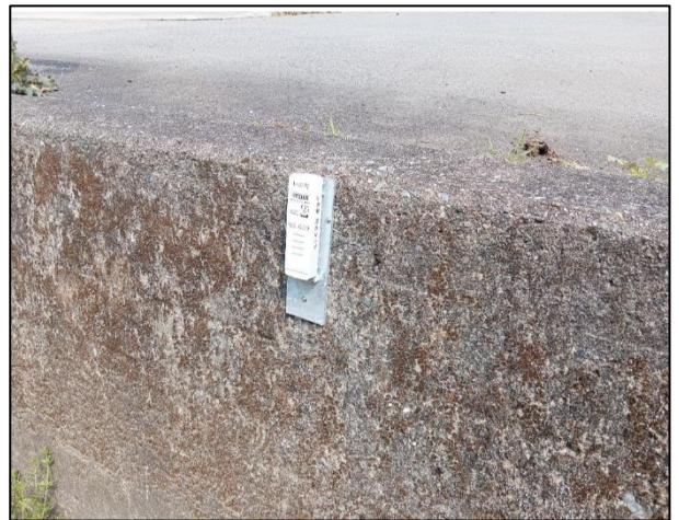
設置箇所（近景）
