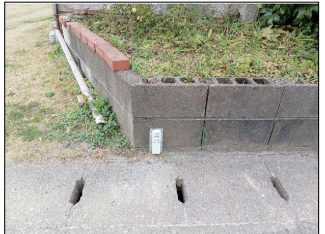
設置箇所（近景）
