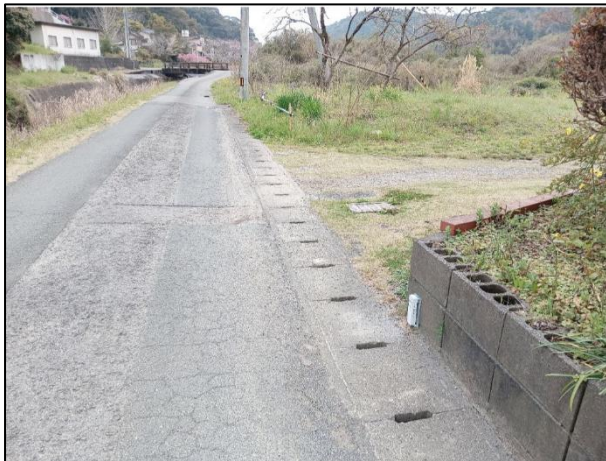
設置箇所（遠景）
