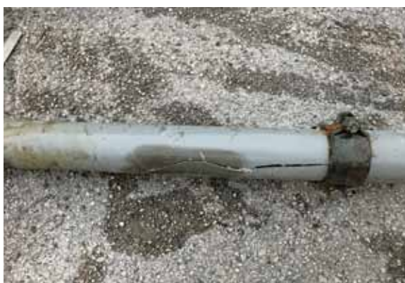
【破損した水道管】
