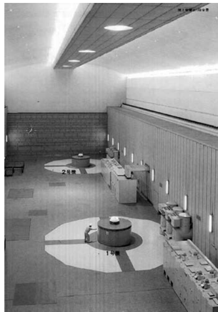
地下300mにある本川発電所
