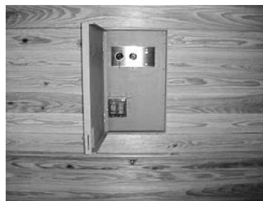
非常電源コンセント
