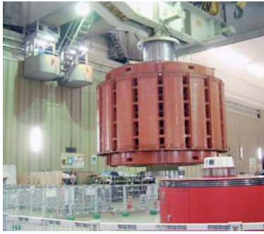
地下300mにある本川発電所
