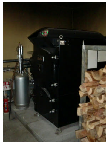
木質バイオマスボイラー
