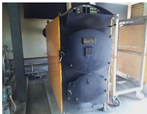
木質バイオマスボイラー
