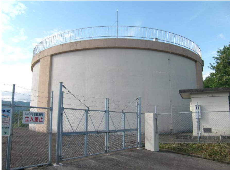
伊野・伊野南配水池
