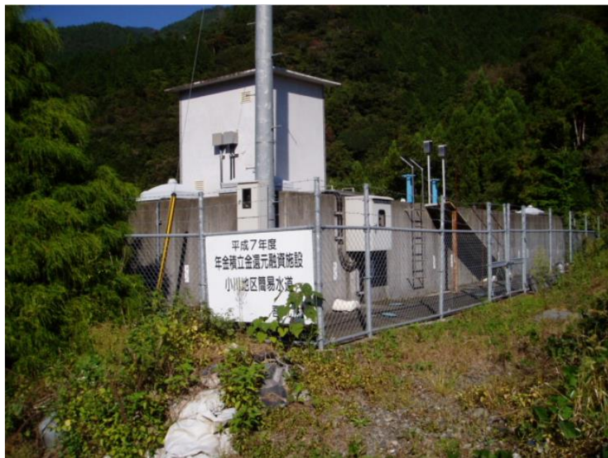
吾北・小川上向式ろ過池
