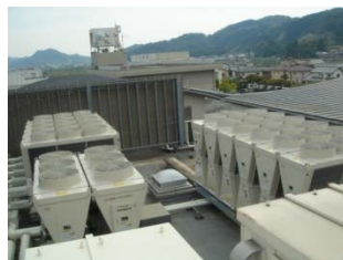
高効率空調機
