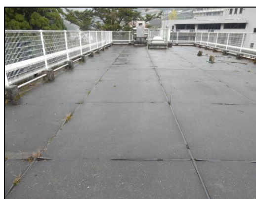
目地シーリングの破損
