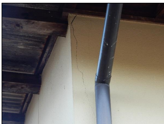
外壁のひび割れ・亀裂
