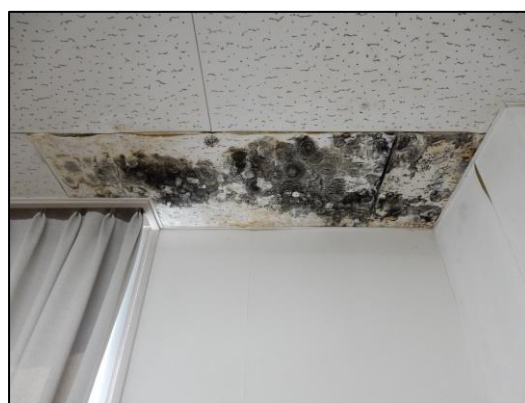
雨漏れ・漏水
